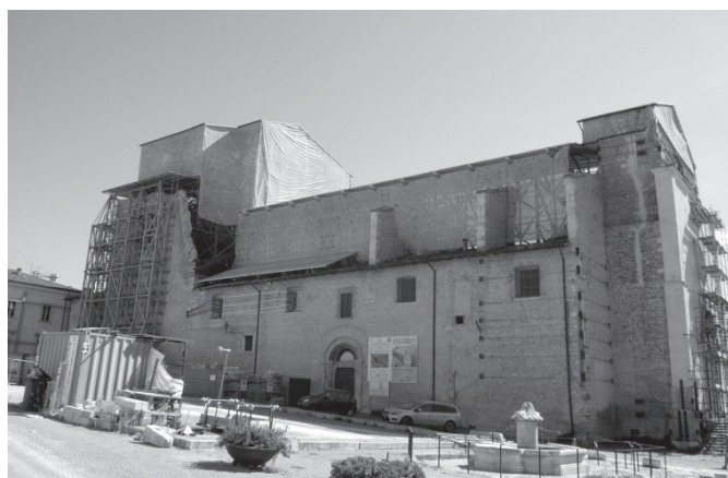
写真7 修復中の教会 Church of Santa Maria Paganica (Saint Mary Paganica)。幌をかぶった中央左部分は天井が落下。建築された時代によっても被害の程度が異なるという。
